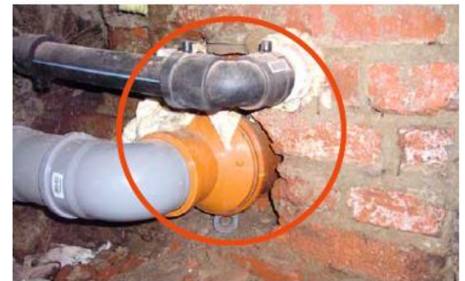
Radoneintrittspfade an unzureichend abgedichteten Leitungsdurchführungen
